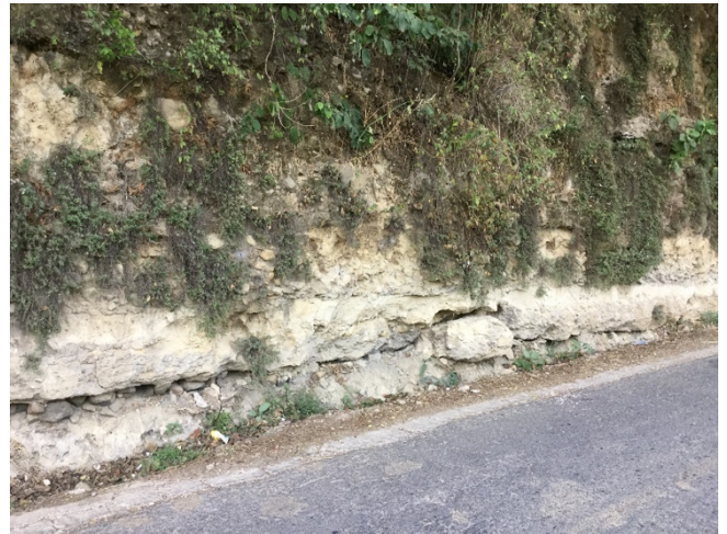
Figura 60. Corte del camino donde afloran materiales vulcano sedimentarios, estos materiales presentan erosión diferencial, lo que ha ocasionado pérdida del pie del talud en algunas zonas, incluso caída de bloques. Carretera Vieja, Xochitlán.
