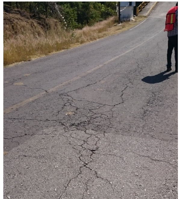
Figura 57. Fracturas en caminos debido al paso de transporte pesado.
