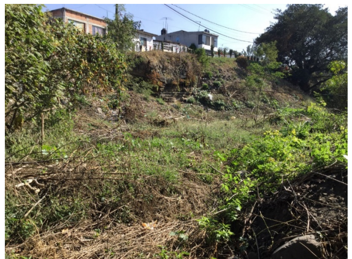
Figura 50. Riesgo de derrumbes por la erosión de las laderas de los drenajes, que afectaría a las viviendas cercanas.
