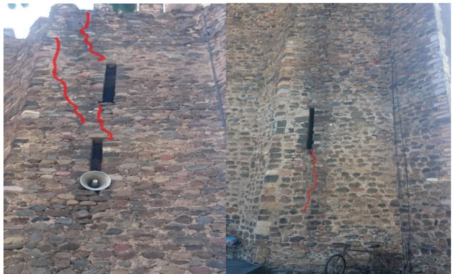
Figura 35. Costado de la iglesia principal del municipio de Yecapixtla, en rojo se resaltan posibles agrietamientos debido a desgaste natural o eventos telúricos.
